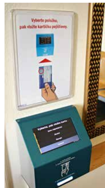
ukázka instalovaného zařízení v čekárně
